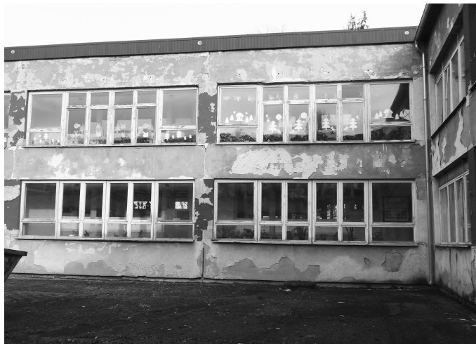
Mgr. J. Petrik: "Budova školy potrebuje ihneď odstrániť havarijný stav okien a fasády"
